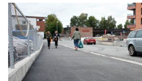
Det gjenstår fortsatt arbeider på Bekkestua nord, men det er også mye som er ferdigstilt. Her nytt fortau i Nadderudveien. Foto: Sofie Meta
