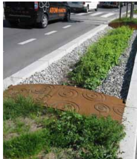
Infiltrasjonsløsning, Ensjøveien, Oslo Bjørbekk & Lindheim
