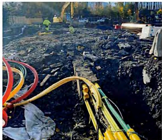
Teknisk infrastruktur i bakken
